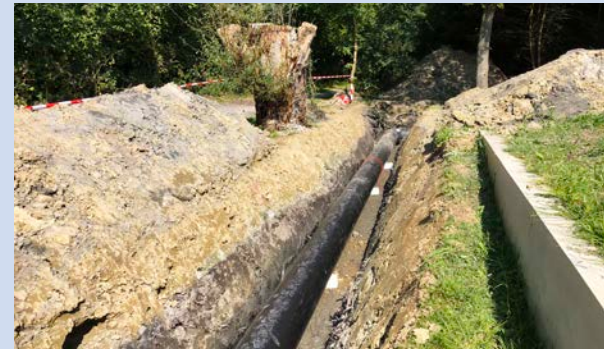
Fernwärmeleitung kurz vor Gebäudeeintritt AVA
