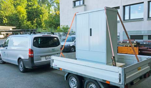
Schaltschrank «made in AVA» (Bestimmungs-ort: PW Neuseeland, Rorschacherberg)
