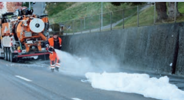
Schaumaustritt in der Verbindungsleitung Walzenhausen-Rheineck (Shampoo in Schmutzwasserkanalisation)
