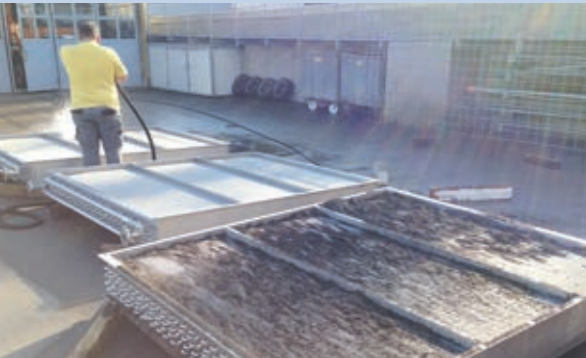
Reinigung der Wärmetauscher
