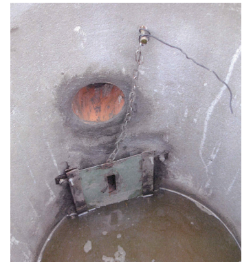
Steckschutz als Drosseleinrichtung (Quelle: Bauverwaltung Heiden)
