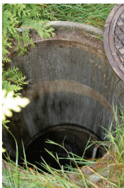
Schachterhöhung mit Brunnenring (Quelle: AVA)
