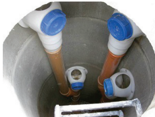
Anschluss an Schacht mit Absturz und Notüberlauf FALSCH (Quelle: www.innenliegender-absturz.beton-tille.de )
