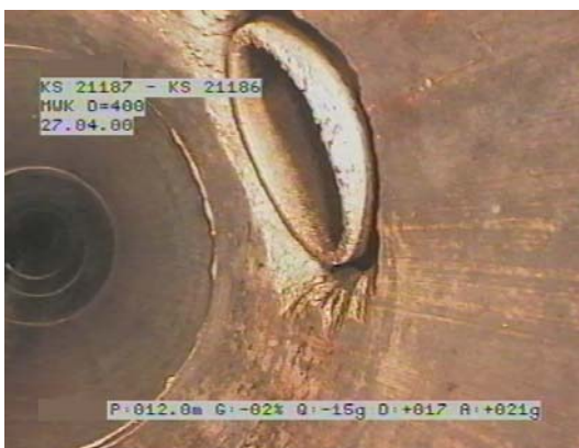
Bild 7: Defekter seitlicher Anschluss
