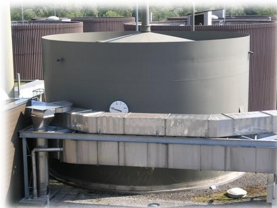
Gasometer zur Klärgasspeicherung
