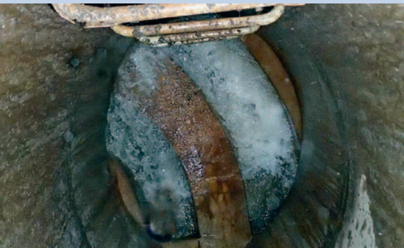
Typischer Doppelschacht mit hydraulischen Problemen
