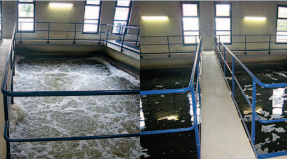
Biofiltration: Ansicht auf ein- und ausgeschaltete Zellen
