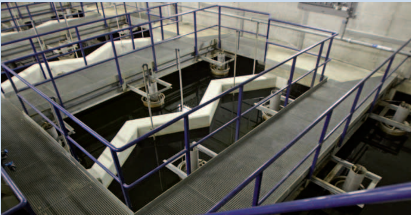
Raumfiltration mit Dynasand®-Filter zur Abtrennung von partikulären Stoffen wie z.B. Mikroorganismen oder geflocktem Eisenphosphat aus dem Schmutzwasser
