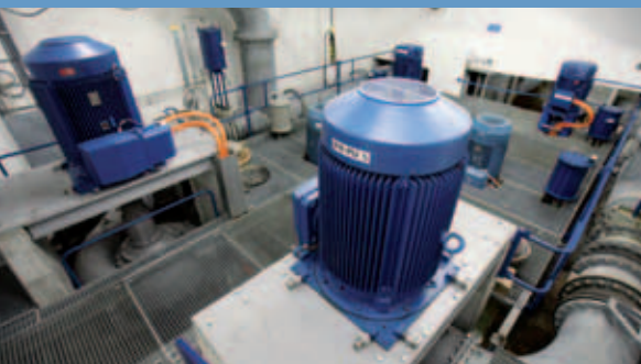
Hauptpumpwerk mit vier Trocken- und zwei Regenwetterpumpen
