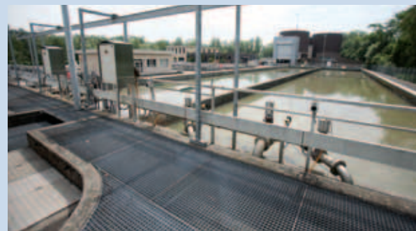
Vorklärbecken zur Abtrennung des Primärschlammes
