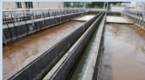
Schmutzwasserzulauf in die Anoxzone, hinten die Belüftungszone
