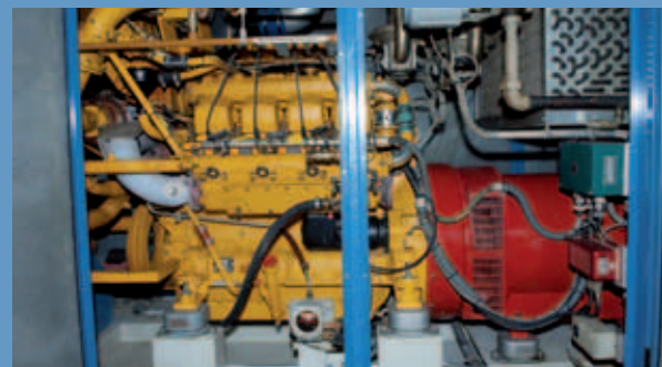
Gasmotor (Blockheizkraftwerk/BHKW) zur Strom- und Wärmegewinnung
