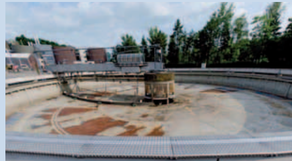
Nachklärbecken zur Abtrennung des Belebtschlammes vom gereinigten Schmutzwasser (oben gefüllt, unten leer)
