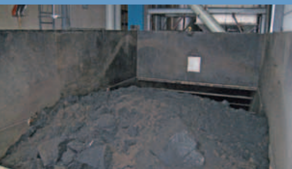
Annahmehunker für entwässerte Klärschlämme
