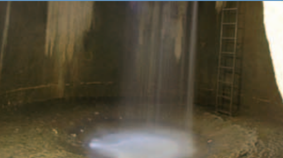
Toostasse an der Sohle des Wirbelfallschachts in Rorschacherberg
